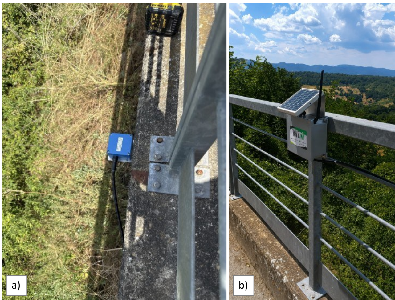
Figura 5 - a) Clinometro biassiale afferente al nodo Nord 5 installato nella parte NO dell'abitato; b) nodo Nord 5 con relativi pannello solare, batteria tampone e antenna.
