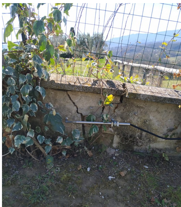
Figura 4 - Estensimetro F1 afferente al nodo Nord 3, installato in corrispondenza di una serie di lesioni di un muro di recinzione presso un'abitazione privata nella parte N dell'abitato.
