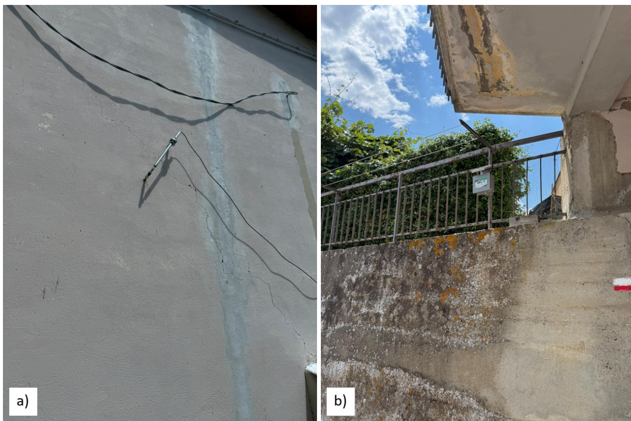
Figura 8 - a) Estensimetro afferente al nodo Sud 4 installato nella parte SO dell'abitato; b) nodo Sud 4 con relativi pannello solare, batteria tampone e antenna.
